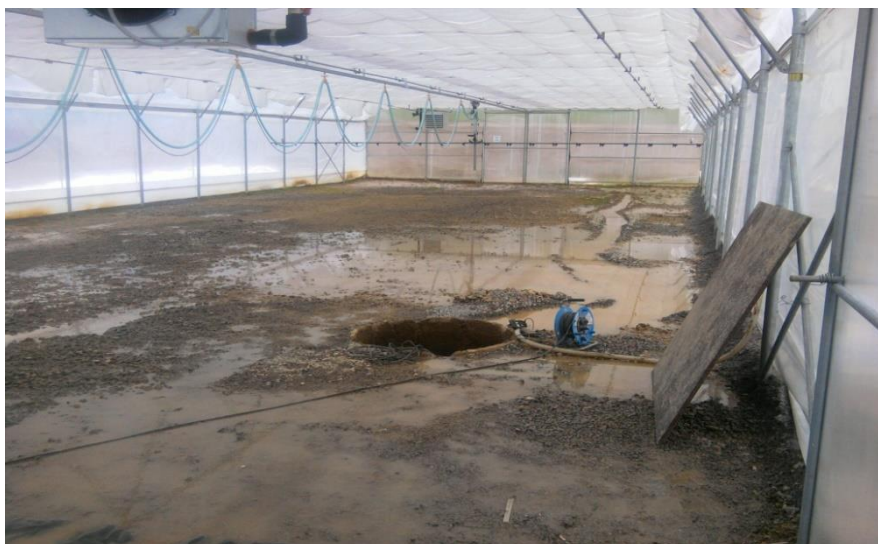
Slika 8: Problemi z meteorno vodo in podtalnico, (Foto: A. Korez, 2013)
